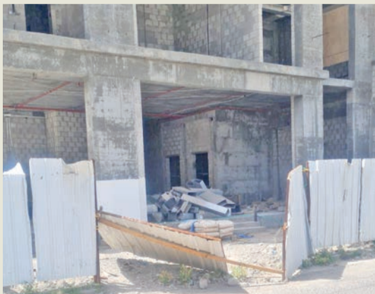
إحدى المخالفات المرصودة
