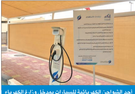
أحد الشواحن الكهربائية للسيارات بمدخل وزارة الكهرباء
